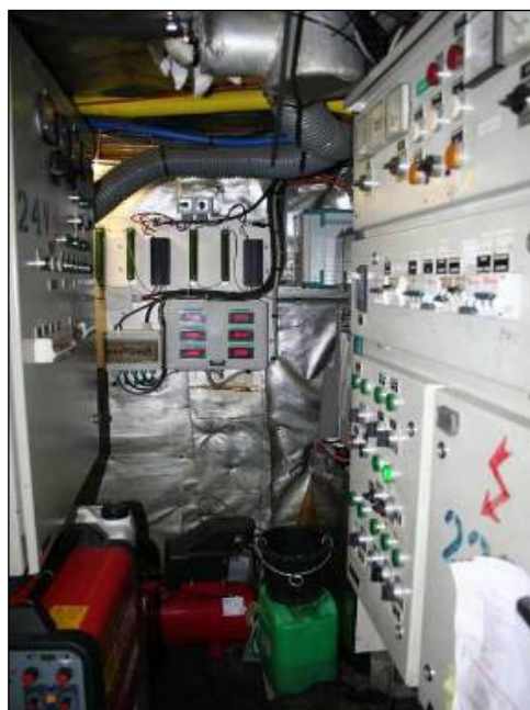
Les armoires électriques
