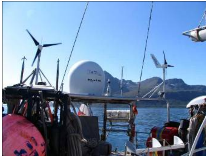
Éolienne sur le portique arrière
